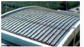
行政院農委會林試所 蓮華池研究中心光電系統 可撓曲式薄膜系統容量 2.04kWp 太陽能板8片、約可發2,555度/年
