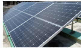
永裕居 六藝住宅太陽光電發電系統 單晶矽模組 系統容量 16.8kWp、太陽能板 67片、約可發2萬1千度/年
