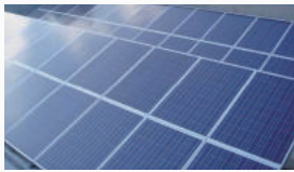
君奕建設 高爾花園太陽光電系統 單晶矽模組 系統容量 12kWp、太陽能板 48片、約可發1萬5千度/年
