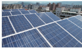
台北捷運公司 貓空纜車旅客 服務中心太陽光電系統 多晶矽光模組 系統容量 10kWp、太陽能板 40片、約可發1萬2700度/年
